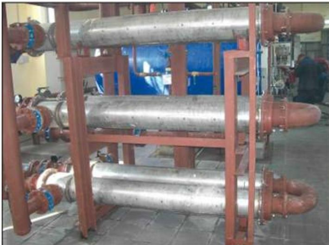
Рисунок 8 - Теплообменники ВВПИ в котельной МУП «Теплосервис»
